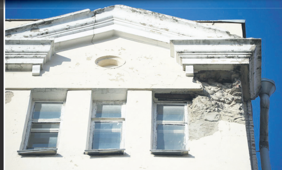
От дома каждый день падают куски штукатурки
