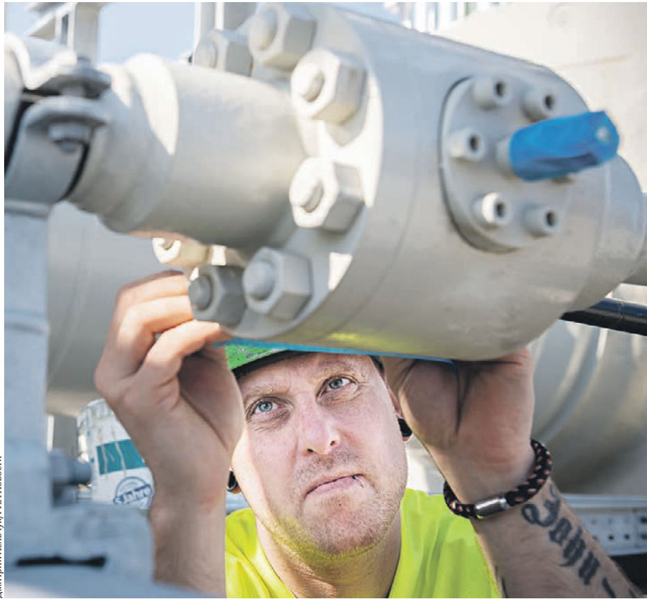
Весна 2021 года. Специалист газораспределительного центра магистрального трубопровода «Северный поток — 2» ведет работы в немецком городе Любмин
