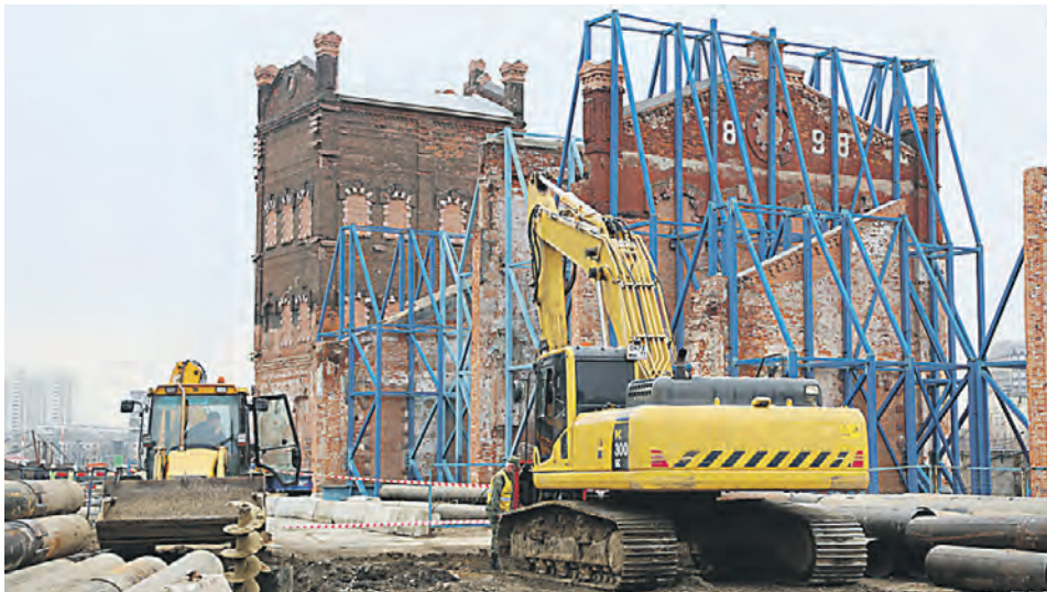
29 марта. Бережная передвижка исторических строений на территории машиностроительного завода «Борец». Фото: Наталья Шатохина
