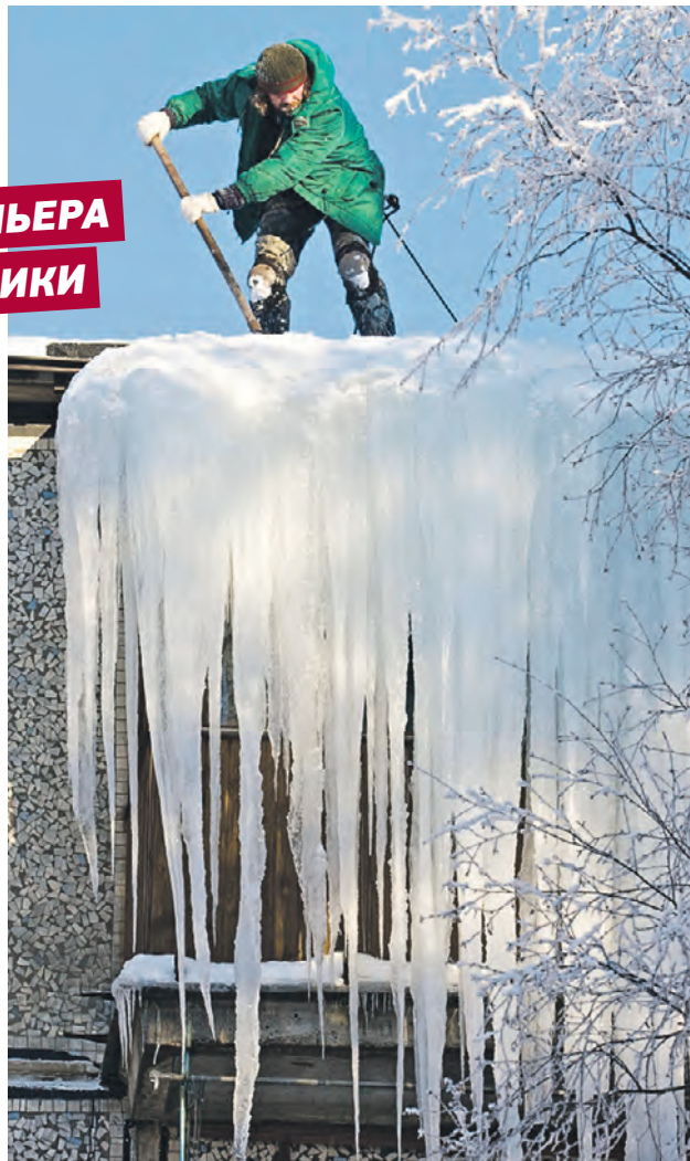
Сотрудник управляющей компании сбивает сосульки с крыши здания, фото 2010 года
