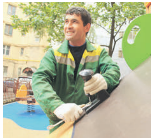
Рабочий Аббас Гадаев устанавливает детскую площадку по дворе на Садовнической набережной. Фото 2017 года
