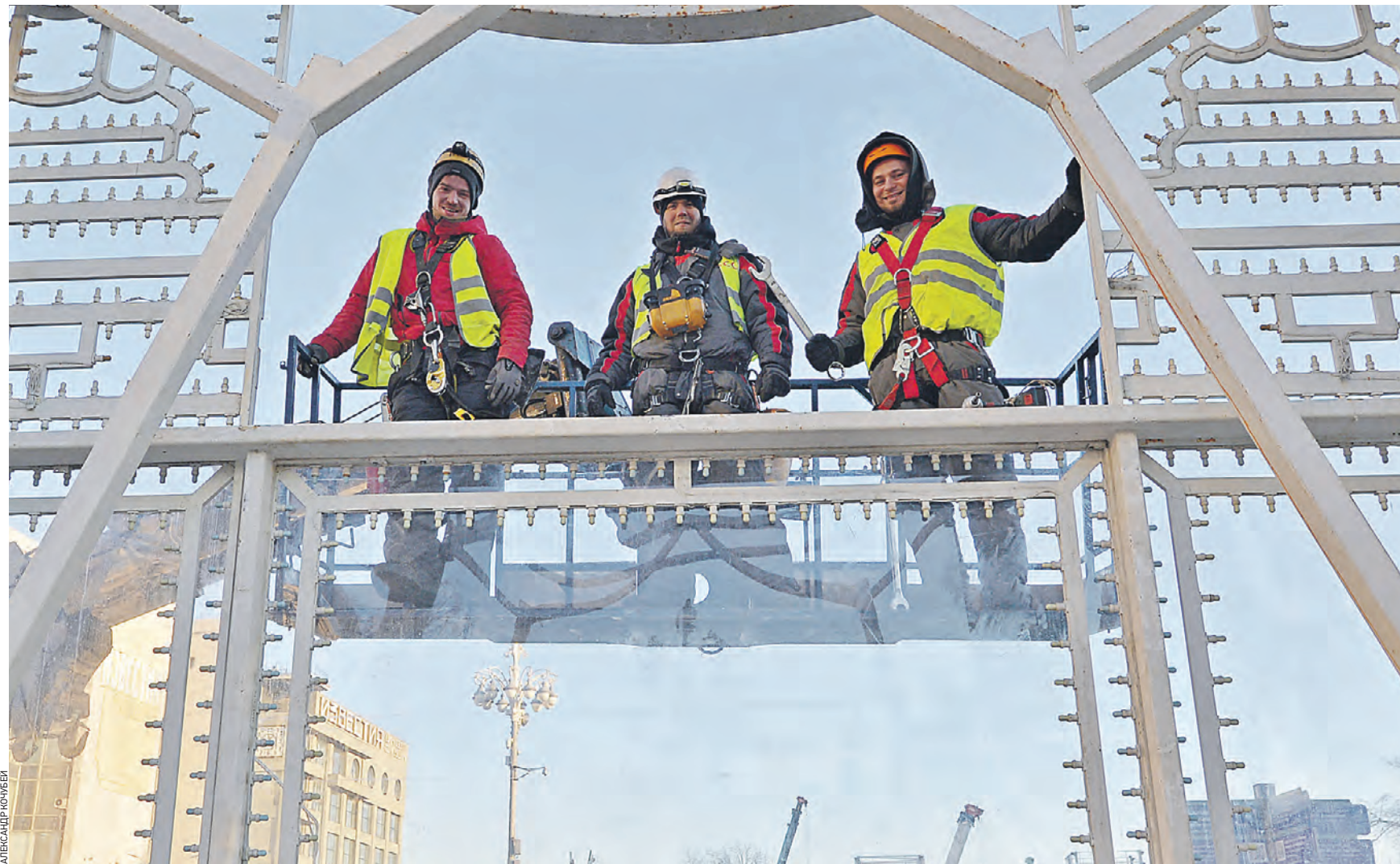
Вчера 10:27 Слева направо: монтажники Михаил Рукин, Дмитрий Цинк и Антон Зарницкий устанавливают конструкции световой арки в Новопушкинском сквере. Таких новогодних декораций в Тверском районе будет несколько
