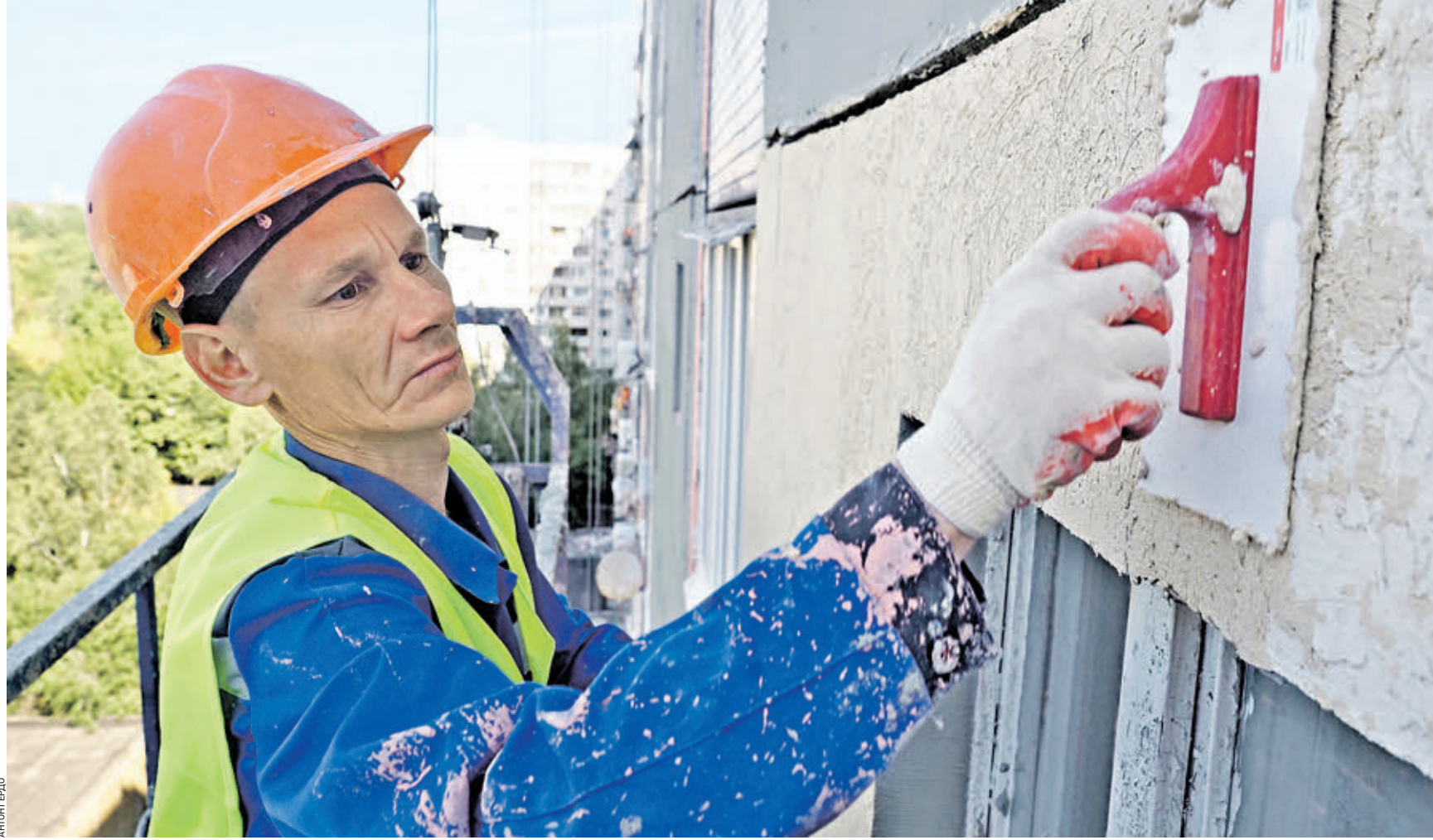
29 августа 11:45 Рабочий Дамир Кашапов на подвешном фасадном подъёмнике наносит на стену ремонтного дома закрепляющий слой — декоративную штукатурку «короед», которая позволяет создать необычный дизайн. Это натуральный и экологичный материал
