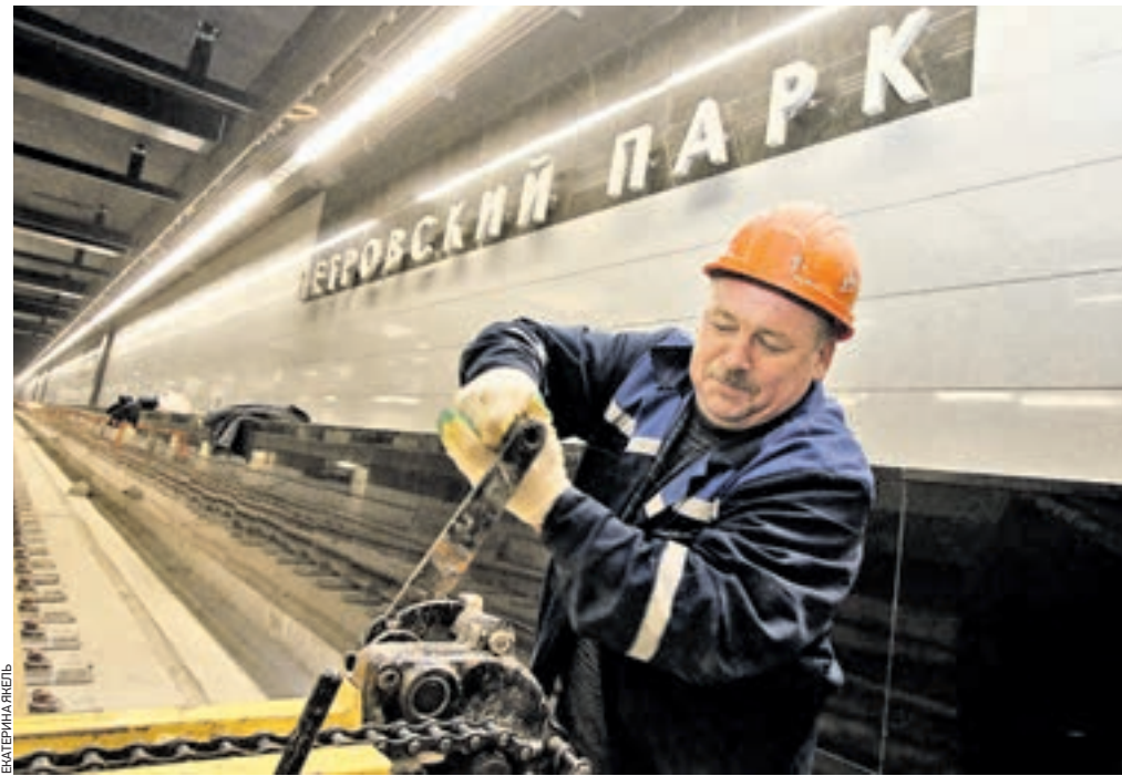
16 сентября 13:20 Рабочий Игорь Скороходов проверяет укладку рельсов на станции «Петровский парк» Третьего пересадочного контура метро
