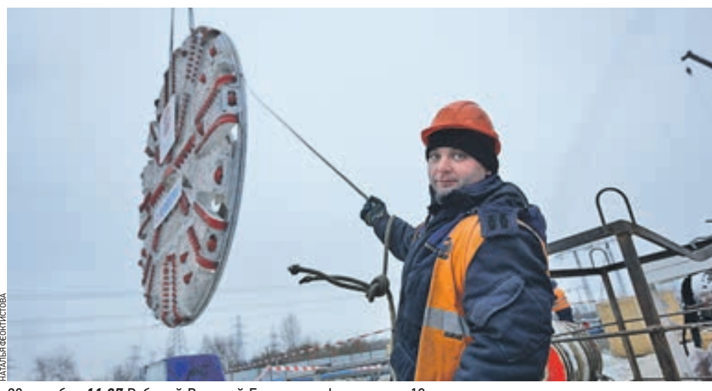
23 декабря 11:37 Рабочий Валерий Гришин на фоне ротора 10-метрового тоннелепроходческого щита, который будет запущен в работу на Кожуховской линии метро 28 декабря
