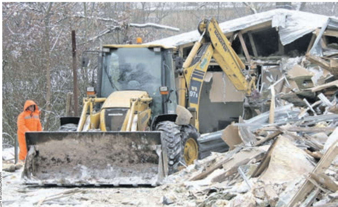
Вчера 10:37 Парк культуры и отдыха «Фили». Рабочие с помощью техники демонтируют самострой. С наступлением тепла территория, ранее занимаемая павильонами, будет благоустроена и станет доступна для посетителей парка
