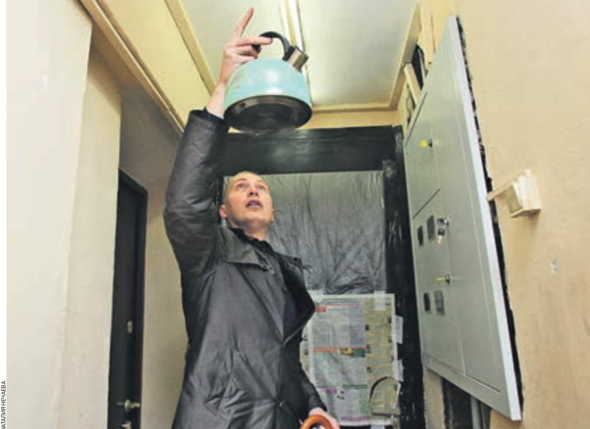
Вчера 14:30 Депутат Алексей Бондаренко выехал с проверкой в дом № 57, корпус № 1, по улице Трифоновской, где накануне произошла авария: прорвало трубу и затопило верхние этажи
