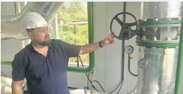
Начальник эксплуатационного района «Северный» Петр Смаль показывает современное оборудование в котельной.
