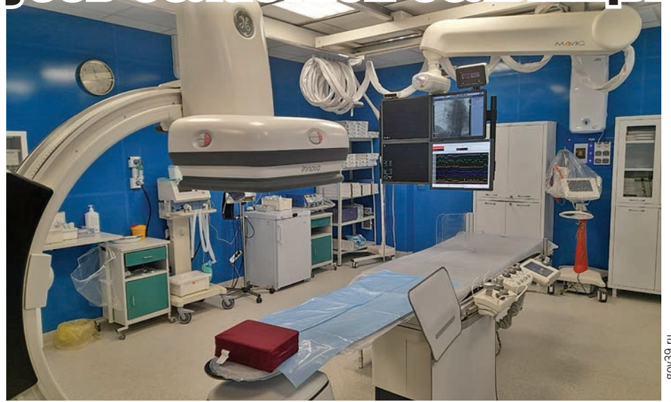
В этом году в больнице установлено современное оборудование: ангиографическая система и однофотонно-эмиссионный компьютерный томограф.
