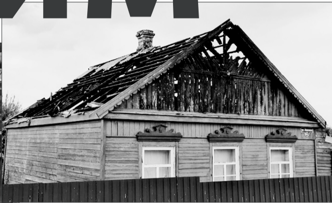
В доме на улице Невского сгорела крыша, но несущие перекладины и само строение успели спасти.
