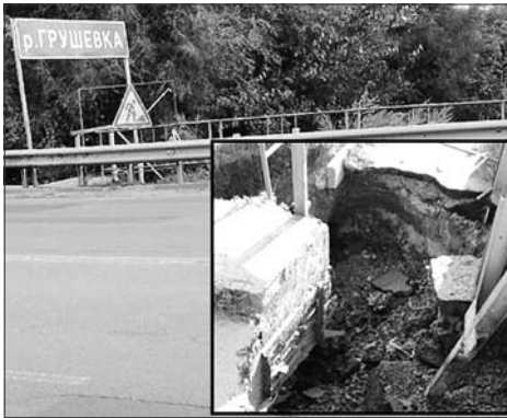
Пешеходы уже три месяца не могут ходить по мосту.
