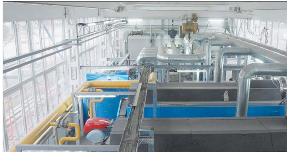
В 2022 году в Шахтах должны появиться 15 новых автоматизированных газовых котельных.
