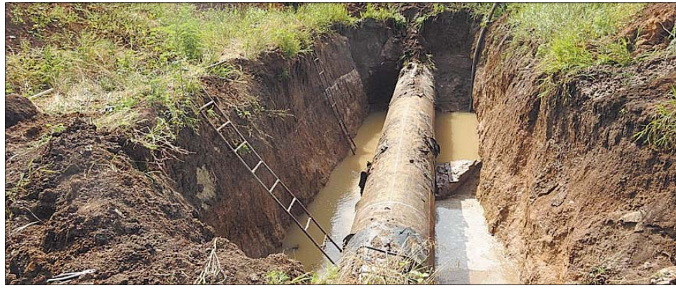
Ремонт водопровода требует больших затрат
