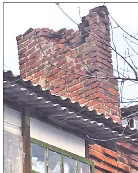
Коммунальщики завалили вытяжку кирпичами в многоквартирном доме.
