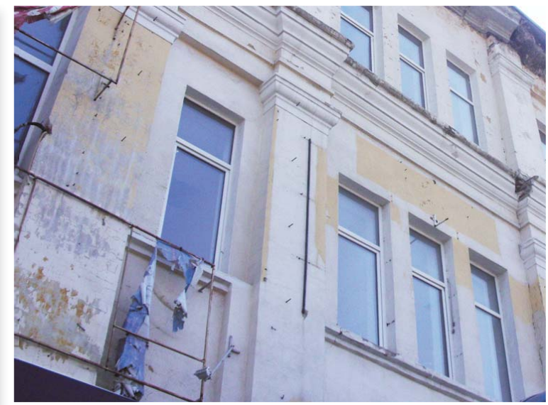
С фасада здания бывшей фабрики «Дончанка» осыпается штукатурка.
